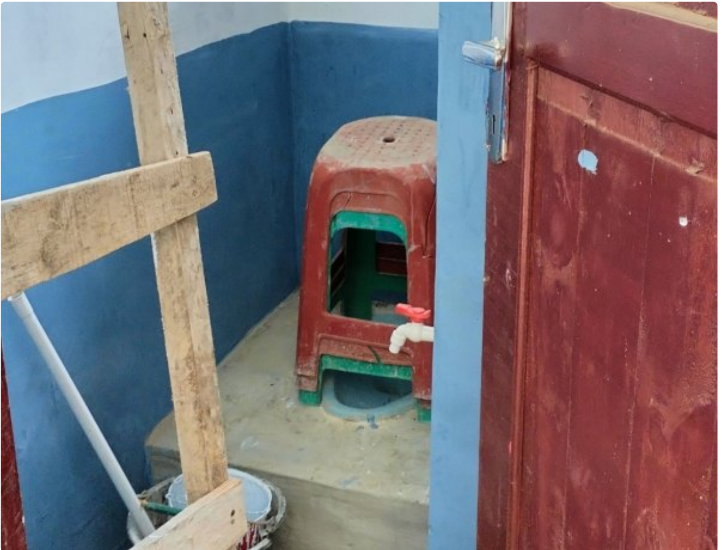
Kondisi toilet (jamban) SMPN Satap 1 Dolat Rakyat, Kecamatan Dolat Rakyat, Kabupaten Karo seharga Rp.169 juta
